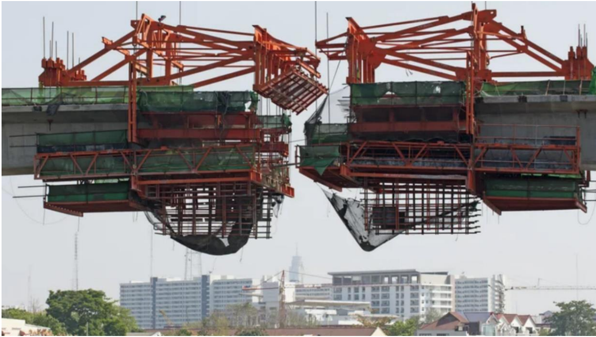
รูปที่ 8-10 ตัวอย่างการก่อสร้างชิ้นส่วนสะพานขั้นสุดท้ายกลางแม่น้ำ
